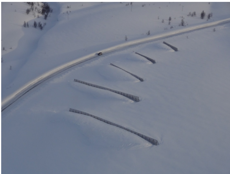
E6 Kvæangsfjellet – eksisterende snøskjermer
