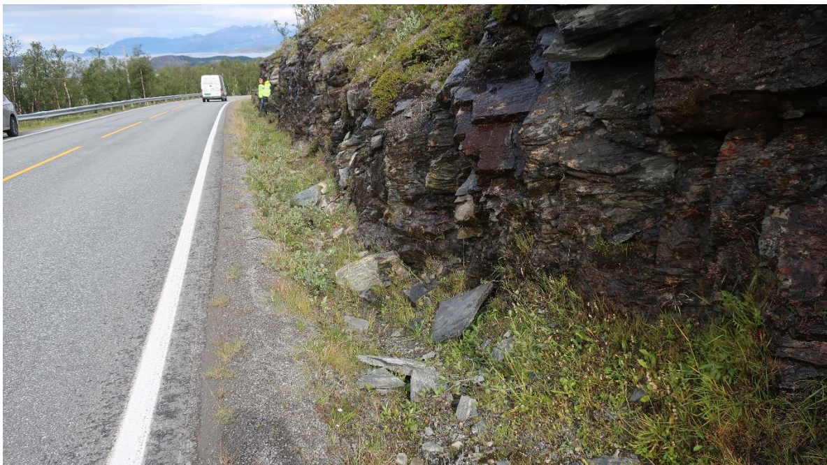
Figur 8: Eksisterende bergskjæring og mindre nedfall i grøft.
