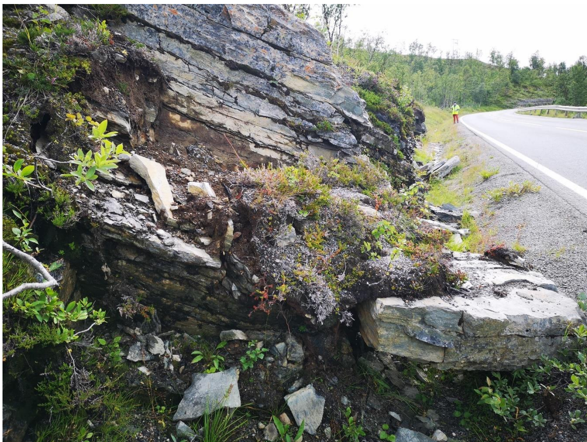
Figur 10: Eksisterende bergskjæring med utglidning av større blokk langs skifrihetsplan.
